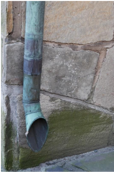
Bild 60: Den för hand formade regnvattenrännan i koppar är ett exempel på hur det samtida starka hantverkarskunnandet syns i byggnadens detaljer och hur materialvalen trots efterkrigstidens materialbrist var hållbara och värdefulla. Fotograferad i februari 2016 och sedermera stulen.
